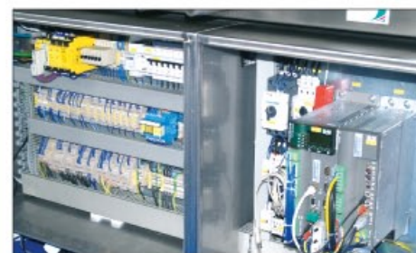
Der PacDrive-Controller und das zentrale Netzteil sind alles, was im Schaltschrank für die Steuerung der gesamten Maschine inklusive Roboter erforderlich ist (rechts im Bild)
